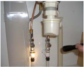
配管の接続状況
