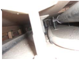
床下の配管状況
