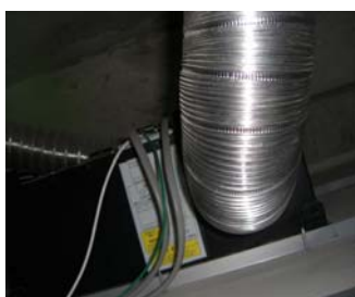
ダクトの接続
